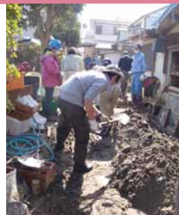
家の中も外も、飯岡海岸特有の砂鉄まじりの重い砂で埋まっていました
